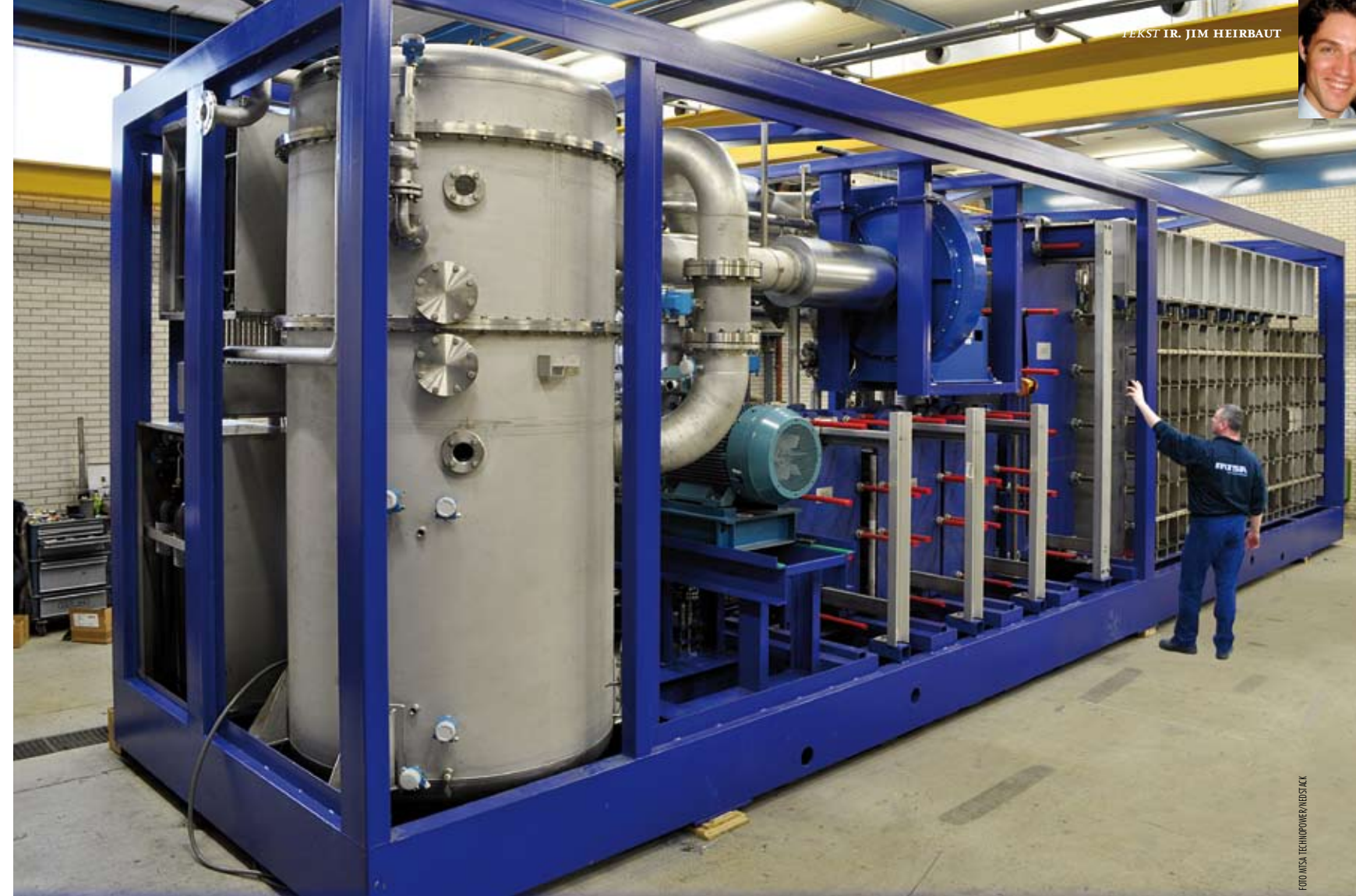
De PEM Power Plant, met links het vat waarin de lucht wordt bevochtigd en rechts de open wand waarin de stacks komen.
